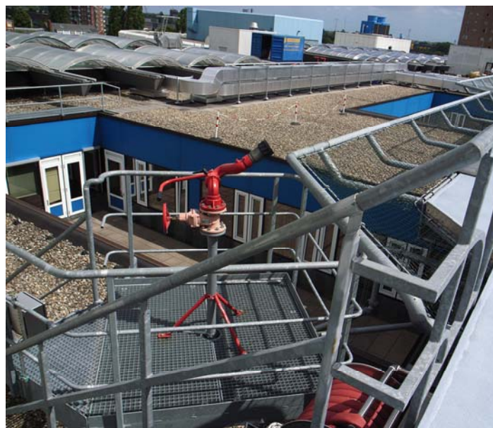
写真7 屋上ヘリポートの消火設備
